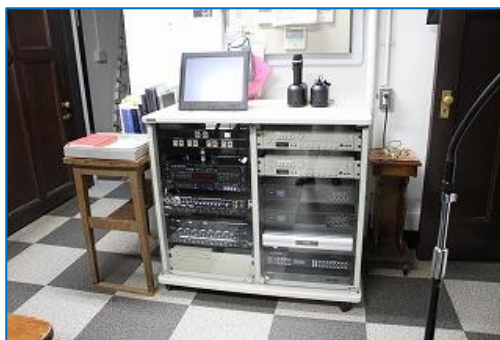
図 14 チャペル控室内音響機器
