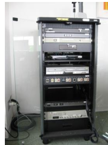
図 7 : 同機器ラック
