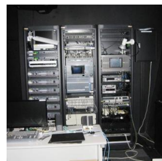
図 15 : ロフト調整室 ロフト2用ラック
