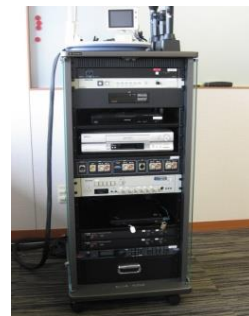
図 9 : 同機器ラック
