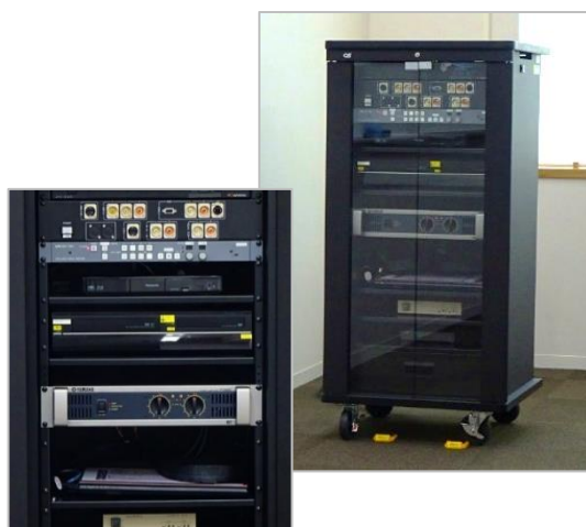
図 5 : N8 号館 AV ワゴン
