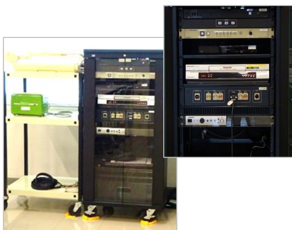
図 4 : N2 号館 AV ワゴン
