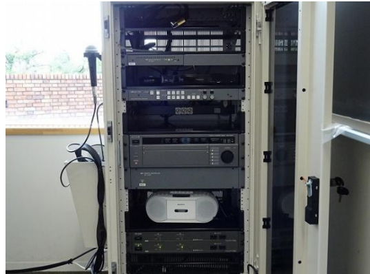
図 8 : AV ラック内部
