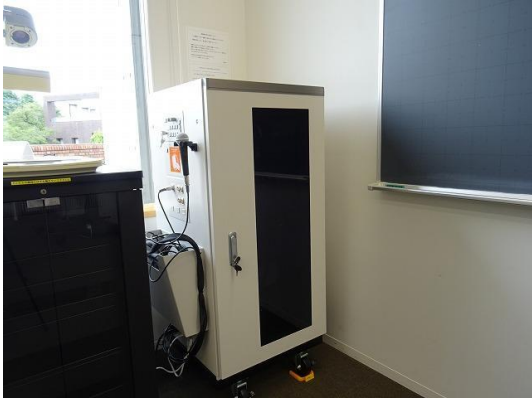
図 7 : AV ラック外観
