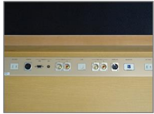
図 4 : AB01 教室 外部入出力パネル
