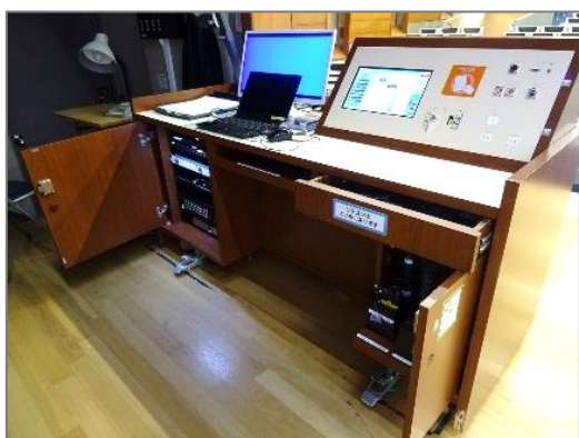
図 20：9号館大教室 操作卓
