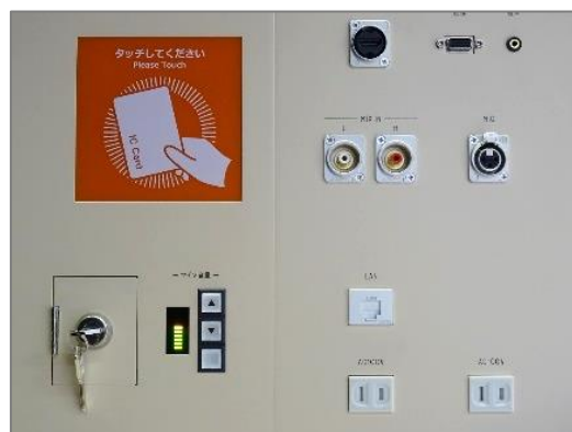
図 21：9号館大教室 外部入出力パネル
