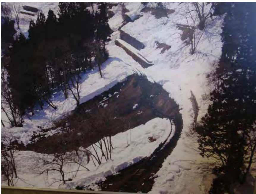
写真3：JR飯山線 線路崩落の現場（2011年3月当時）
