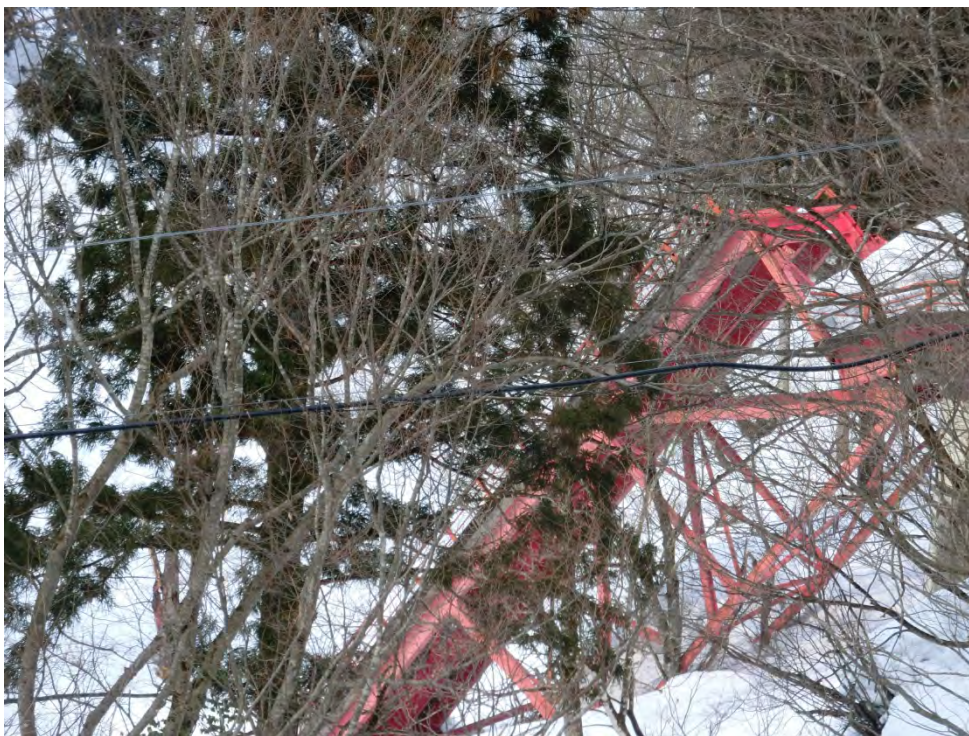
写真 9 : 崩落した中条橋の様子
