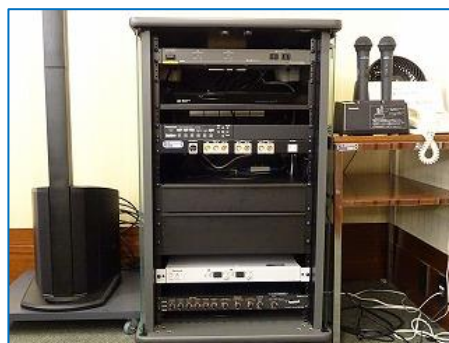
図 16 : 12 号館 2 階会議室 (AV ラックとスピーカー)
