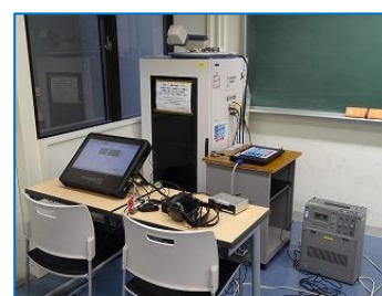
図 3 : 9B03 教室 (AV ラック) Mediasite 設置
