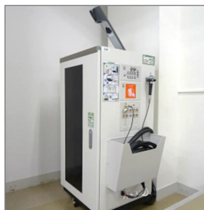
図 12 : 5号館 A 棟 AV ラック
