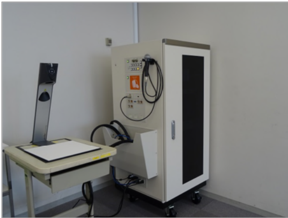
図 6 : D601 教室 AV ラック
